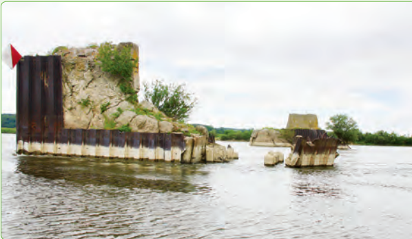
Pozostałości filarów dawnego mostu
